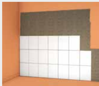
Afb. 24: Tegels worden geplaatst met een dunne laag fermacell Flexibele tegellijm op een volvlakse afdichting (garandeert de afdichting voor de vochtbelastingsklasse A).
